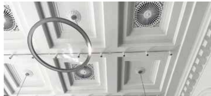
Auch Luftauslässe wurden in den Decken gefunden. Diese waren historisch mit Stuck verziert. Da diese aber nicht brandschutzkonform waren, wurden die neuen Lüftungen nun den originalen brandschutzkonform nachempfunden.
