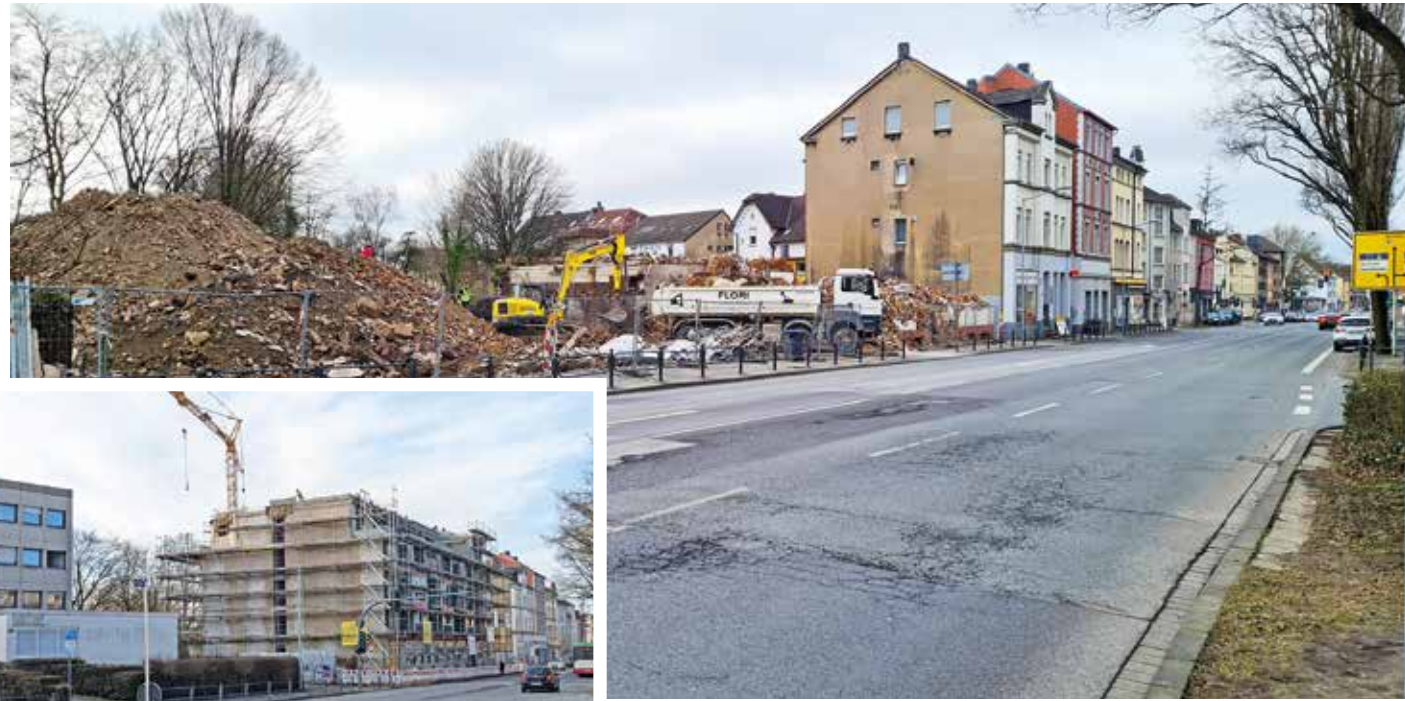
Jahrelang vergammelte eine Häuserzeile an der Ardeystraße in Höhe der Annenstraße, bis 2024 die Bagger kamen. Jetzt entsteht an gleicher Stelle ein modernes Wohngebäude. Der Einzug ist für den 30. Juni geplant Foto: Dix
