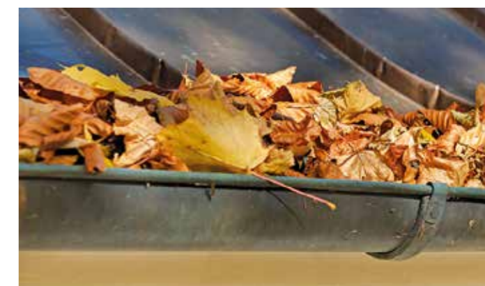
Starker Laubfall im Herbst kann Dachrinnen und Fallrohre verstopfen. Läuft das Regenwasser dann nicht richtig ab, sind Feuchtigkeitsschäden die Folge. Fotos: Panthermedia
