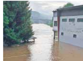
Das vom Wasser stark geschundene Haus des Clubs Wasserfreunde Witten. Einmal Wasser von unten (wie auf dem Foto), dann durchs Dach von oben.
