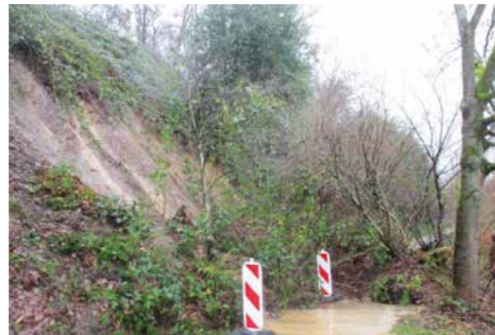
Deutlich ist der Hangrutsch zu sehen. Geröll und Vegetation blockieren den Weg und sorgen für die Sperrung des Ruhrtalradweges und des Leinpfades.
