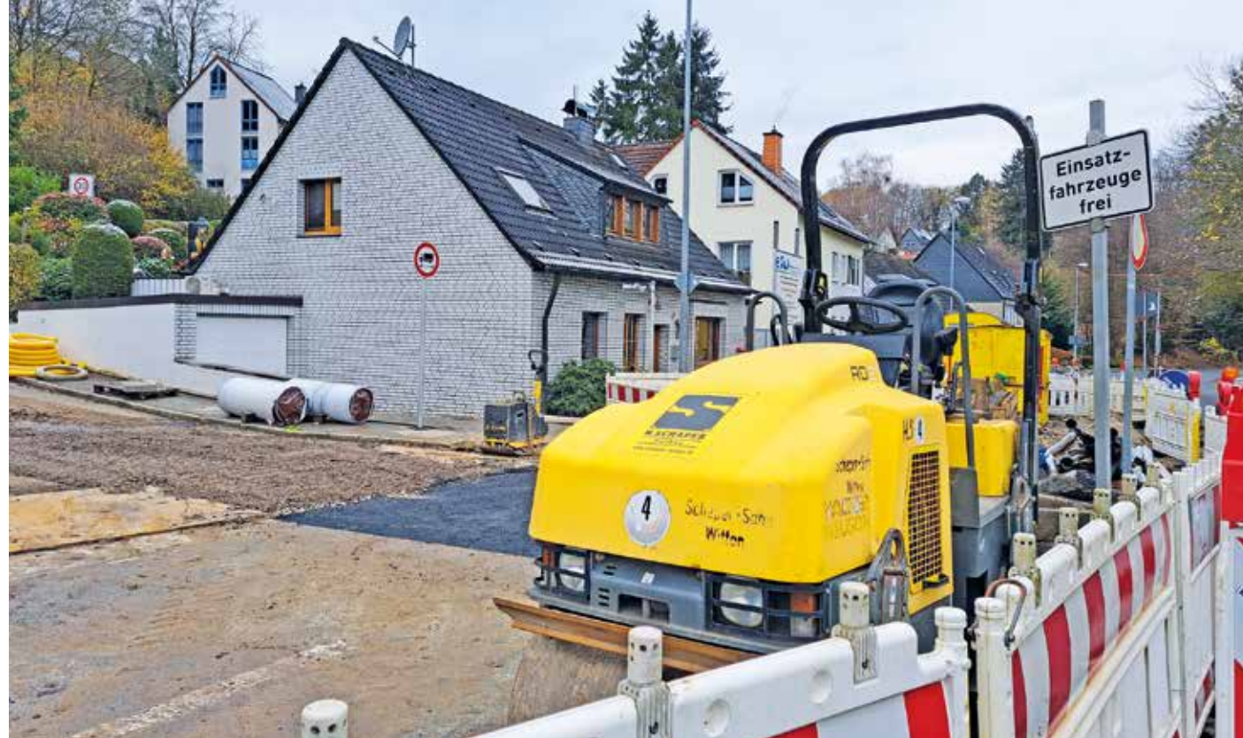
Die Baustelle an der Rauhen Egge. Noch bis mindestens April 2024 werden die Kanalbauarbeiten anhalten. Für rund 900 Buchholzer aus dem Siedlungsgebiet Rauhe Egge bedeutet das weite Umwege, um ins Hammertal zu gelangen. Die Strecke führt über den Waldweg und die Obere Rauhe Egge. Letztere wurde notdürftig ausgebessert, damit diese Umleitung überhaupt möglich ist. Ein noch größeres Problem stellt sich allerdings für die Rettungskräfte, die vor der Baustelle wieder umdrehen - trotz des Schildes „Einsatzfahrzeuge frei“. Foto: Pielorz
