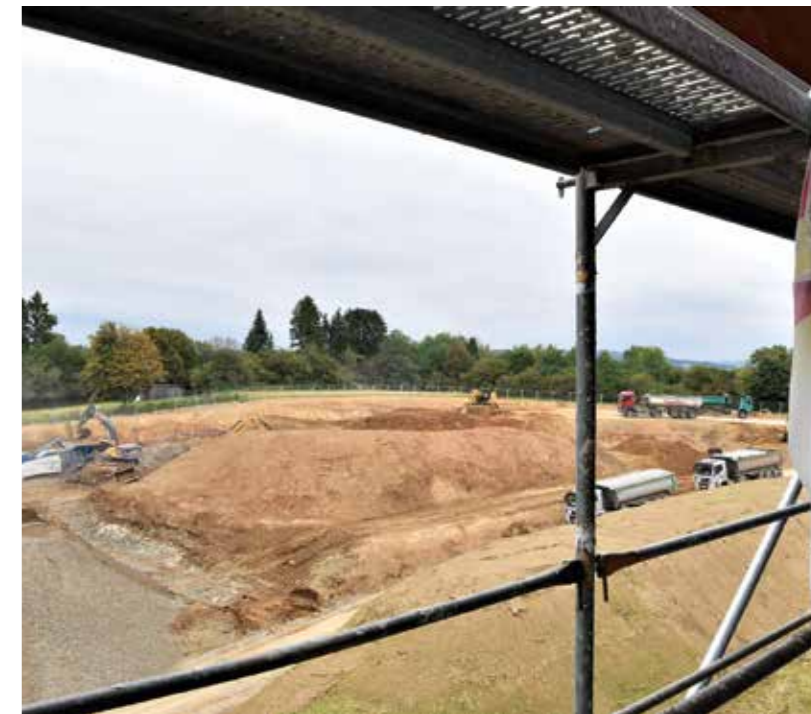
Die Baustelle fotografiert aus dem vierten Stock des neuen Gebäudes der Kreispolizeibehörde, das in unmittelbarer Nachbarschaft des GAZ entsteht.
