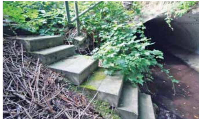
Auf dem Teil des Bachlaufs, der am 19. Oktober in Hattingen versteigert wird, befindet sich eine baufällige Betontreppe. Foto: Dipl. Ing. Volker Rüping
