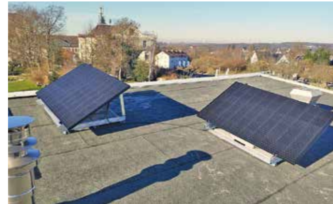
Mini-Solaranlage der Stadtwerke Hattingen auf einem Flachdach Foto: Stadtwerke Hattingen GmbH
