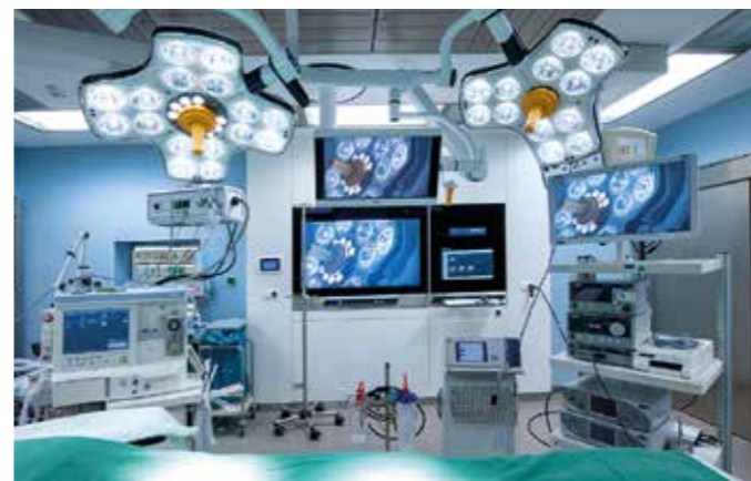
Technische Besonderheit: Die neuen OP-Lampen leuchten mit starker LED-Technik das Operationsfeld optimal aus. Foto: Volker Beushausen
