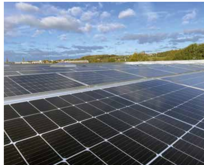
PV-Anlage bei ARDEX in Witten.
