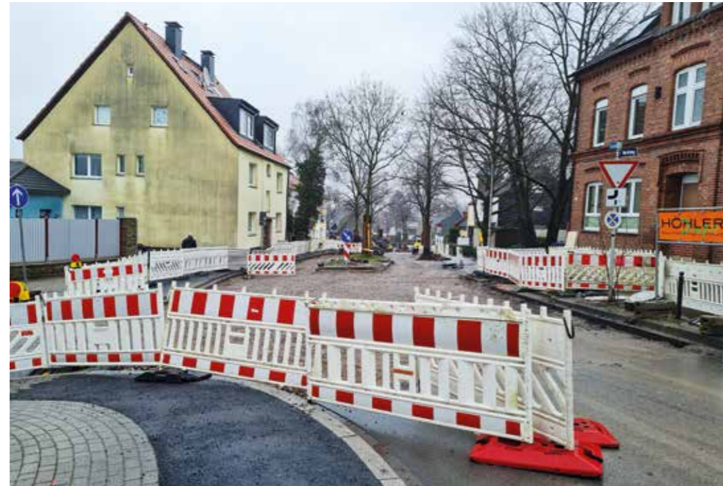
Kreisstraße: Ende Januar waren die Bauarbeiten zur Erneuerung der Fahrbahndecke bereits im vollen Gange.
