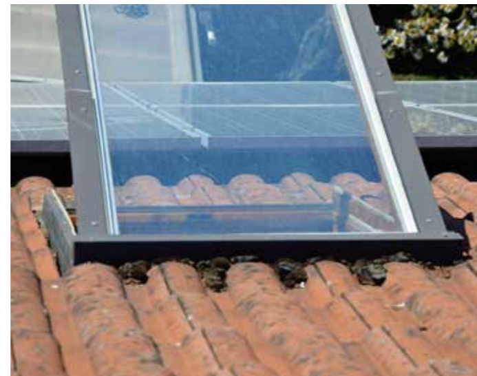
Anschlüsse an Dachdurchdringungen bei Dachfenstern werden beim DachCheck begutachtet. Foto: HF Redaktion/akz-o
