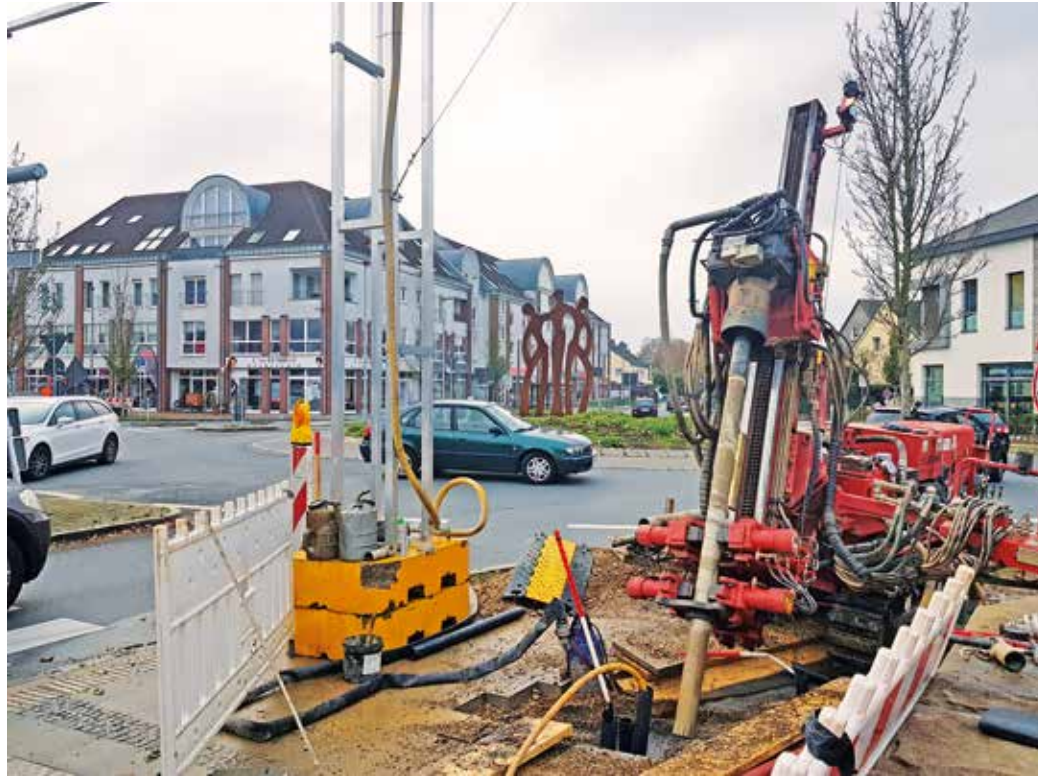
Der Verdacht auf Bergbauschäden führte auch in Herbede vor einiger Zeit zu aufwendigen Probebohrungen.
