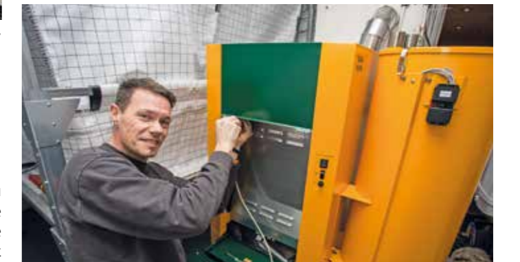
Eine Pelletheizung braucht ungefähr den gleichen Platz wie eine Ölheizung. Die kleinen Holzpresslinge sind jedoch deutlich klimafreundlicher, der Einbau einer Pelletheizung wird deswegen vom Staat durch hohe Zuschüsse gefördert. Foto: Deutsches Pelletinstitut/txn
