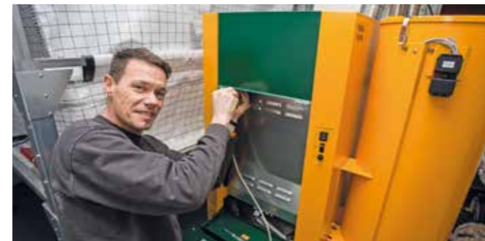
txn. Eine Pelletheizung braucht ungefähr den gleichen Platz wie eine Ölheizung. Die kleinen Holzpresslinge sind jedoch deutlich klimafreundlicher, der Einbau einer Pelletheizung wird deswegen vom Staat durch hohe Zuschüsse gefördert. Foto: Deutsches Pelletinstitut/txn
