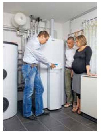
Wenn es draußen richtig warm ist, können viele Wärmepumpen dazu genutzt werden, um die Wohnräume energieeffizient zu kühlen. Foto: txn/Bundesverband Wärmepumpe e.V.
