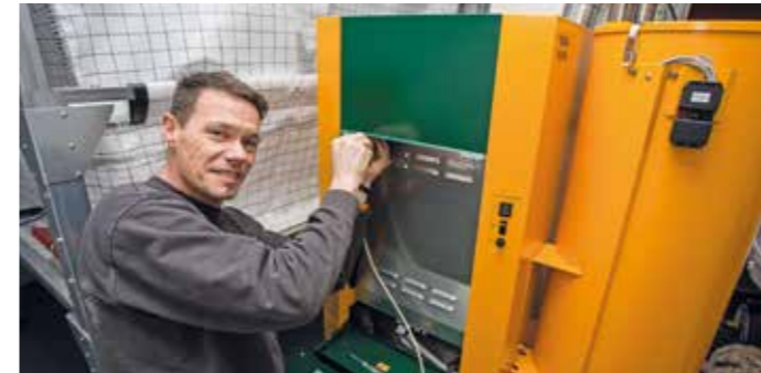
Eine Pelletheizung braucht ungefähr den gleichen Platz wie eine Ölheizung. Die kleinen Holzpresslinge sind jedoch deutlich klimafreundlicher, der Einbau einer Pelletheizung wird deswegen vom Staat durch hohe Zuschüsse gefördert. Foto: Deutsches Pelletinstitut/txn
