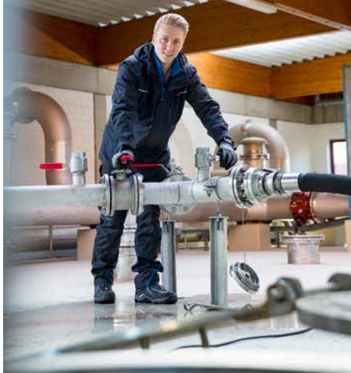
Befüllung des Aktivkohlefilters
