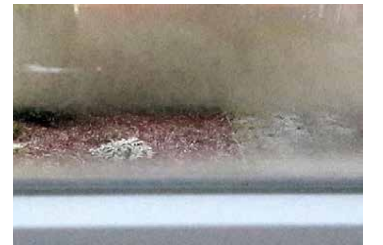
Kein Durchblick am Morgen: Von außen beschlagene Fenster sind kein Grund zur Sorge, sondern Zeichen für eine gute Wärmedämmung der Verglasung. Foto: Energie-Fachberater.de
