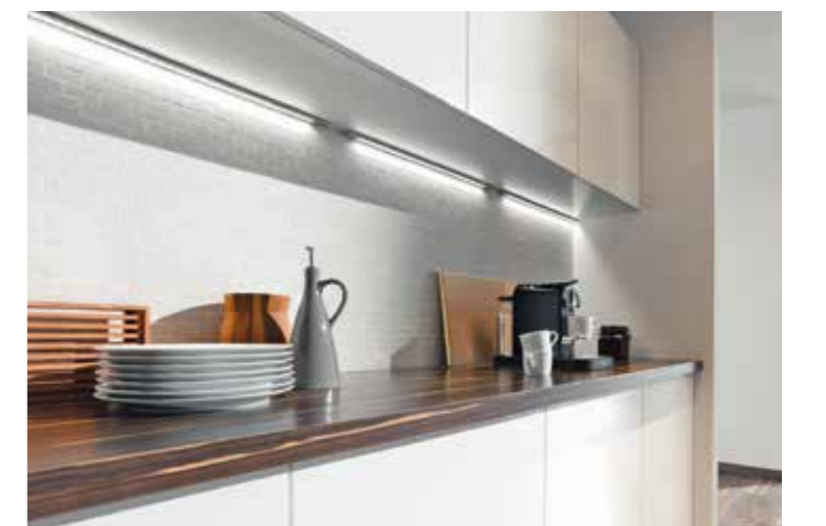
Lineare LED-Leuchten können auch nachträglich installiert werden. Foto: licht.de/Paulmann
