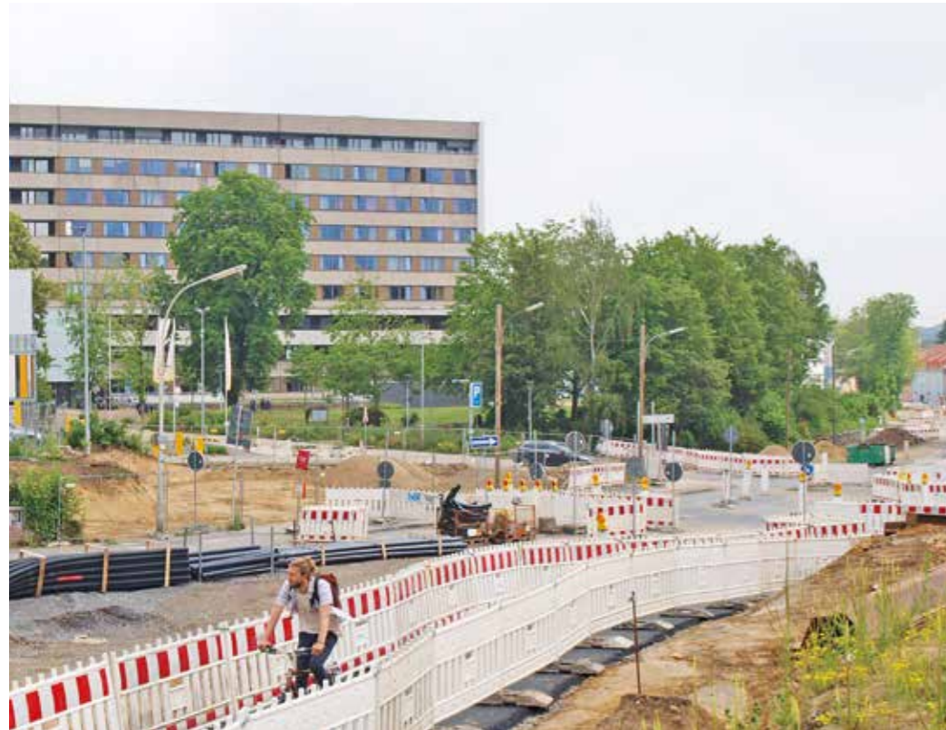
Über die Hälfte der Pferdebachstraße ist bereits fertig, so langsam nimmt die Trasse Formen an. Weil mehr Arbeiter im Einsatz sind, geht es voran. 2012 hat die Stadt Witten entschieden, die Straße zwischen Ardey- und Leostraße auf einer Länge von rund 1150 Metern grundlegend umzugestalten. Baubeginn war Ende August 2018, und zwar im Abschnitt zwischen Ardey- und Schlachthofstraße. Voraussichtliche Fertigstellung der Gesamtmaßnahme sollte im März 2021 sein. Nach derzeitigem Stand verschiebt sich das Ende der Arbeiten um acht Monate. Foto: Rainer Schletter
