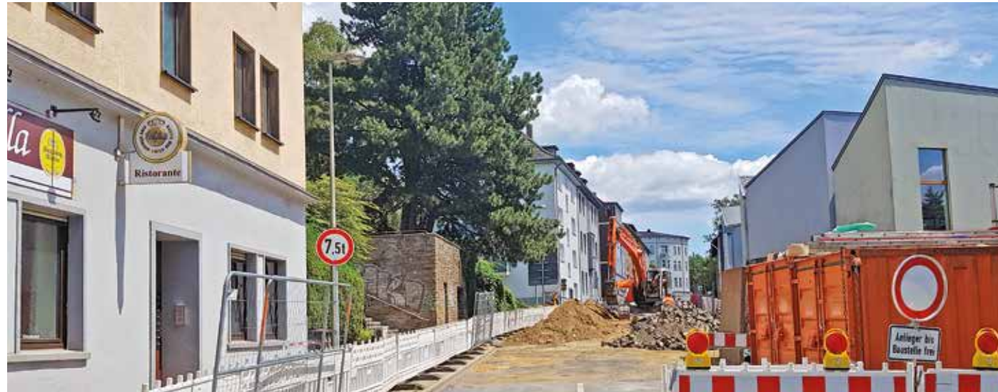
Die Johannisstraße zwischen Luther- und Hauptstraße wird vorübergehend für Radfahrer in beiden Richtungen geöffnet. Dazu wurde die dreiecksförmige Verkehrsinsel in der Einmündung der Johannisstraße einschließlich des Kunstobjekts zurückgebaut und Hinweise auf die neue Verkehrsführung mit gelber Markierung aufgebracht. Im unteren Bereich werden die Radfahrer über den Kornmarkt auf die Hauptstraße geführt. Diese Änderung gilt bis voraussichtlich
