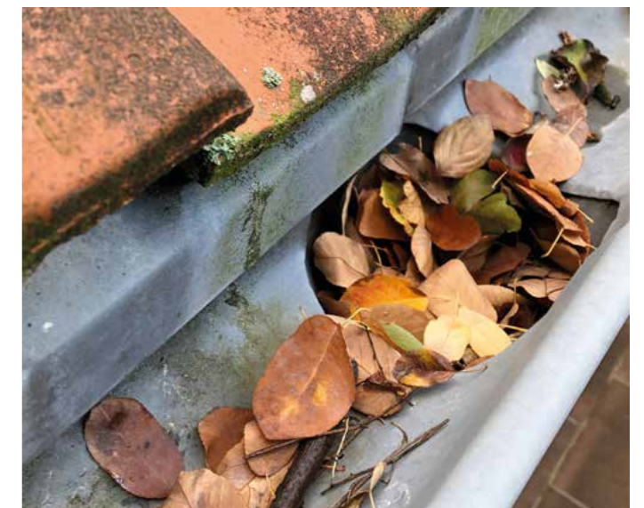
Starker Laubfall im Herbst kann Dachrinnen und Fallrohre verstopfen. Läuft das Regenwasser dann nicht richtig ab, sind Feuchtigkeitsschäden die Folge. Foto: Energie-Fachberater.de
