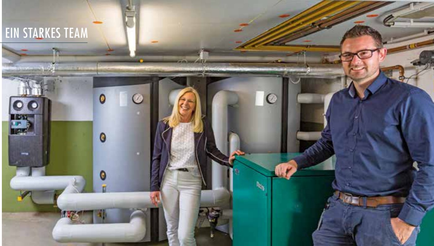
Claudia Pyras (Siedlungsgesellschaft Witten) und Christian Dresel (Stadtwerke Witten) am Mini-Blockheizkraftwerk im Keller des Gebäudes Kösters Hof 4/6. Das BHKW befindet sich in dem kleinen grünen Metallkasten; im Hintergrund sind die Speicher für Warmwasser. Foto: Sascha Krecklau
